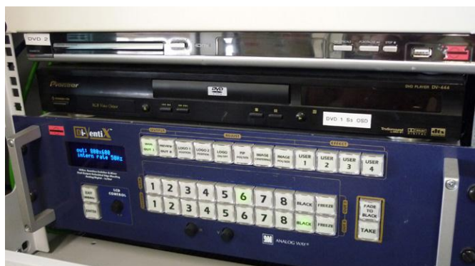
Le Di-VentiX d'Analog Way installé dans la régie
